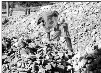
Usina de Reciclagem de Entulho e de Tratamento de Resíduos Sólidos da BR 040 - SLU/PBH
